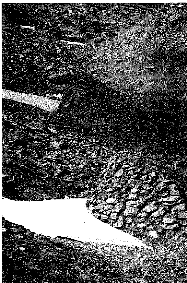
Fig. 4 Coni frangivalanga in terra rivestiti con pietrame sul lato esposto all'impatto della valanga (Foto: D. Santi)
