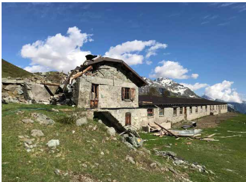
Fig. 6 - I danni della valanga di Vascoccia che ha danneggiato la stalla fotografata in giugno (foto Corpo forestale della Valle d'Aosta).
