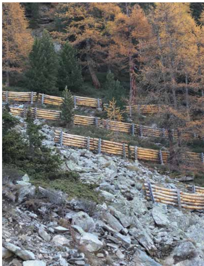
Fig. 8 - Le opere frangi flusso installate nell'estate 2013 presso il sito Pista Larici.
