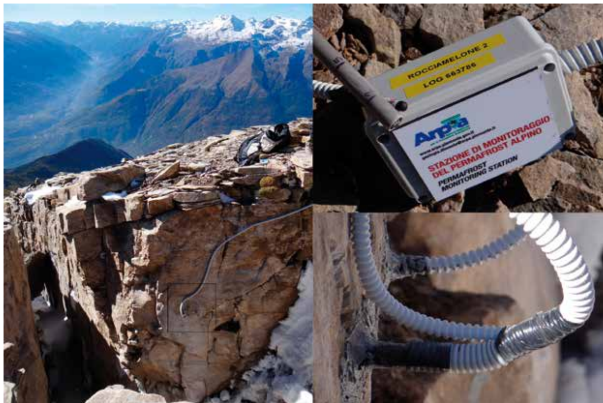
Fig. 9 - Installazione di sensori termometrici in roccia collegati ad un mini-datalogger su una parete con apertura metrica sul M. Rocciamelone a circa 3000 m di quota (Provincia di Torino).
