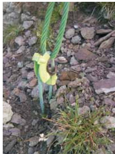
Fig. 8 - Particolare di un ancoraggio non protetto dalla corrosione e con redancia rotta in strutture fermaneve non omologate.
