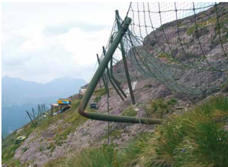
Fig. 7 - Puntoni tubolari piegati in strutture fermeneve non omologate.
