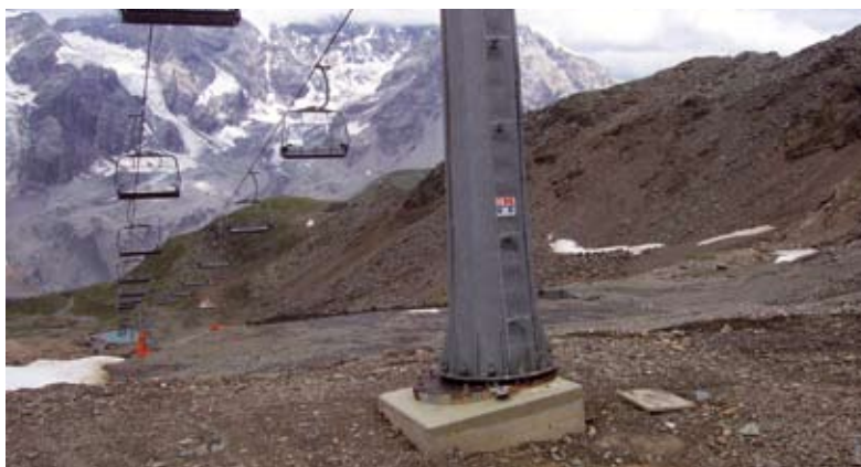
Infrastrutture per il turismo invernale colpite dai fenomeni di disgelo del permafrost.
