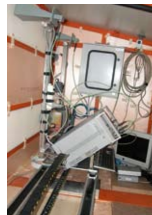
Fig. 5 - interno della casetta che ospita il sistema LISA.
